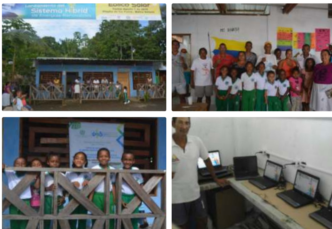
Figura 5. Sistema de energía renovable híbrido (eólico – solar), instalado en el corregimiento de Playa Potes, Municipio de Bahía Solano.
